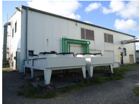
Betriebsgebäude mit Notkühlanlage
