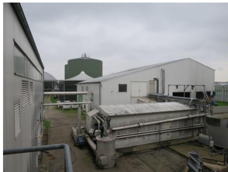
Biogasanlage & BHKW Betriebsgebäude
